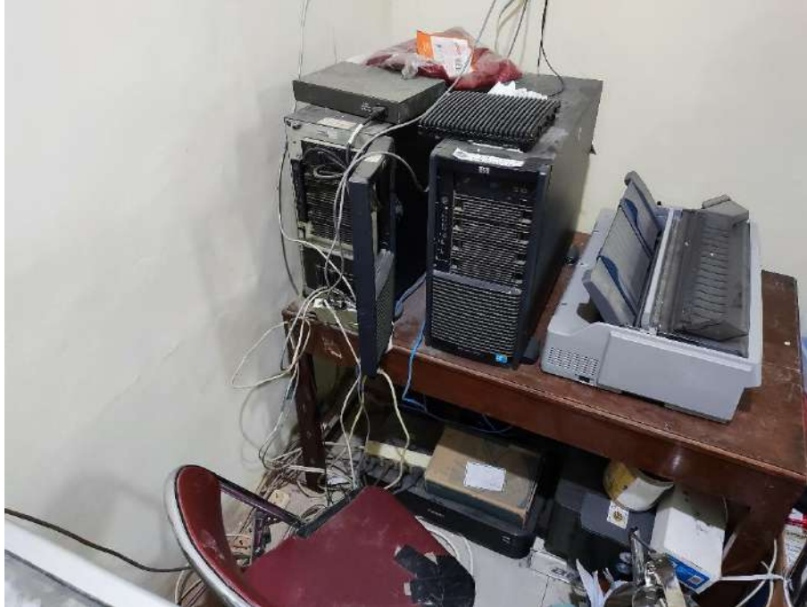
Gambar 2.4 Ruang Server Kantor Pertanahan Kota Madiun
