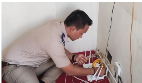
Gambar 3.12 Output kabel LAN sebagai penghubung wifi
