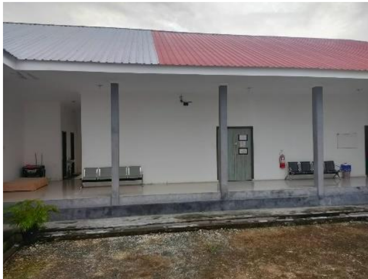
Gambar II. 2 Nampak salah satu sudut dinding kantor di area timur
